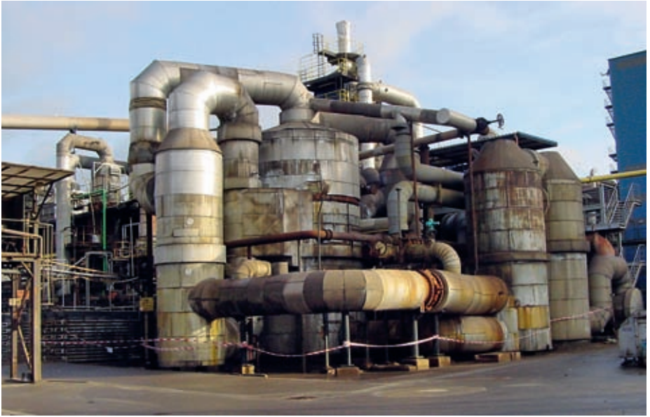
Die Schwefelsäureanlage der MHD
